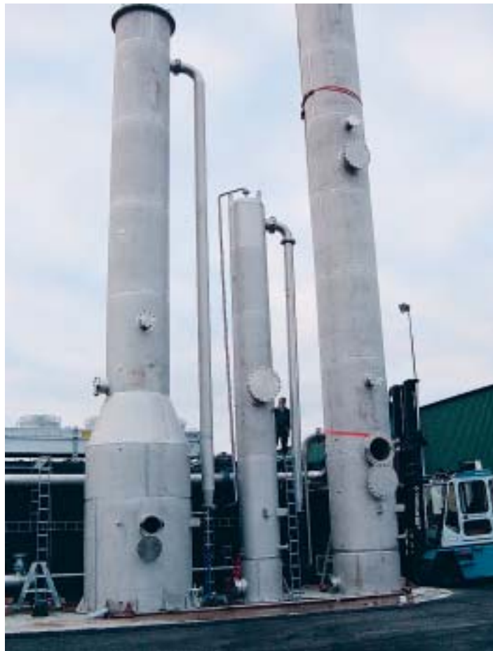
Bild 2. Svensk uppgraderingsanläggning under montering för vidare leverans till Tyskland. Anläggningen kan rena 1 250 Nm 3 biogas/h. Bilden tagen hos Malmberg Water AB i Yngsjö.
