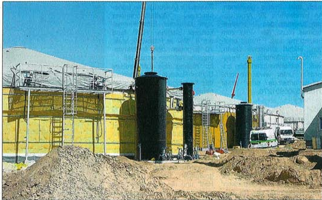
In „Klarsee“ entstehen 40 Module zur Stromerzeugung, deren Anschlussleistung 20 Megawatt betragen soll. Im November 2006 wurde das erste Modul in Betrieb genommen.
